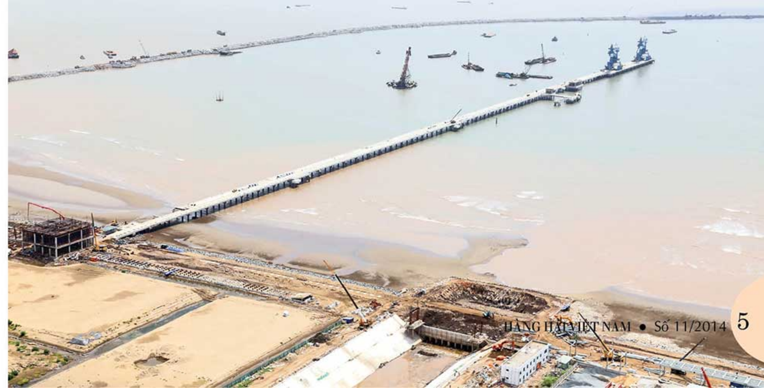
Dự án để chắn sóng và cảng biển Trung tâm Điện lực Duyên Hải do Portcoast tư vấn
